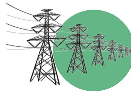
Металлические опоры линий электропередачи
